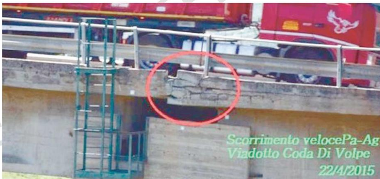
Le crepe alla base del viadotto «Coda di Volpe» nei pressi di Bolognetta in un frame del filmato di «Mare Vivo»
